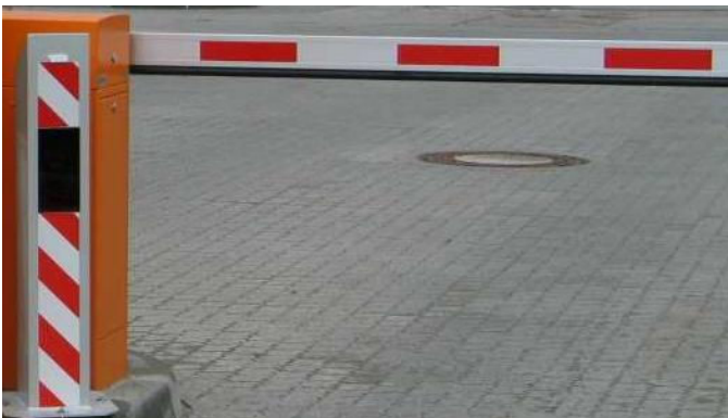
CAR-READER Videosäule an einer Schranke installiert
